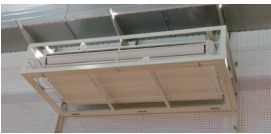
中学校体育館に設置されたエアコン
